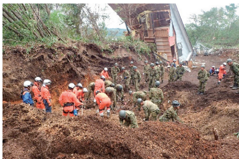
平成30年9月胆振東部地震による現場搜索 (提供：消防研究センター)
